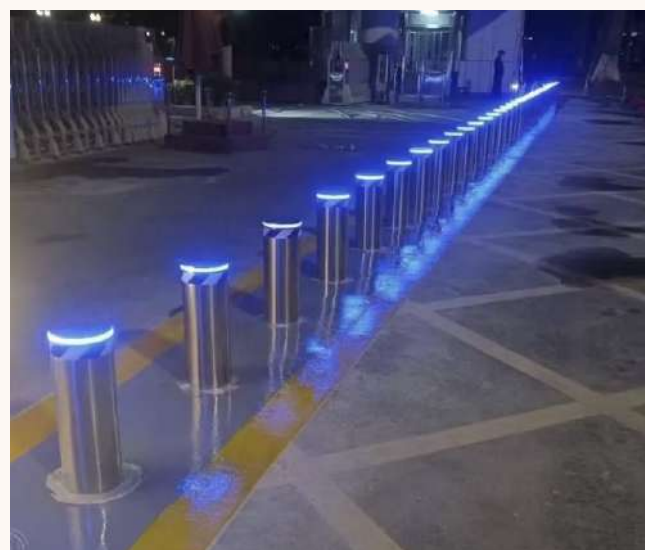
Nočná inštalácia – LED prstenec v prevádzke
